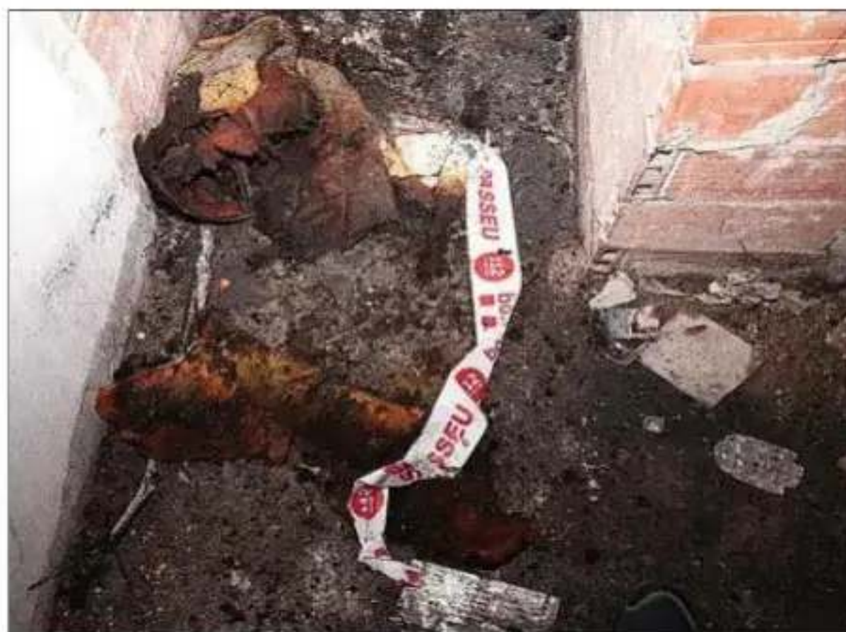
La zona de trasteros en la azotea afectada por el incendio. ARABA PRESS
